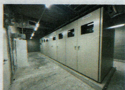
改修後の電気室
