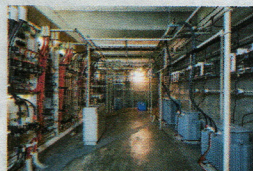
改修前の電気室
